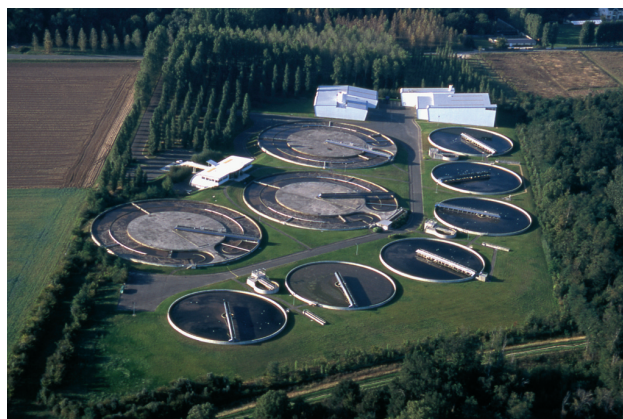
Station d'épuration à Charigny (Loiret).
