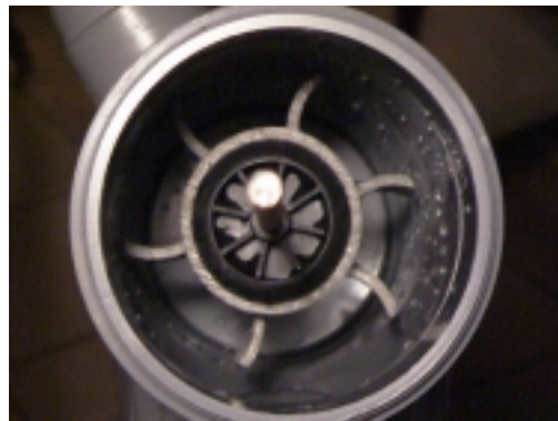
Vue de la turbine dans la canalisation
